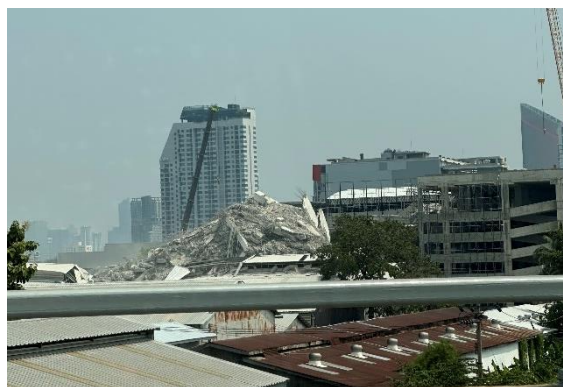
チャトチャック地区の建設中ビル倒壊現場 (2025 年 3 月 29 日筆者撮影)
